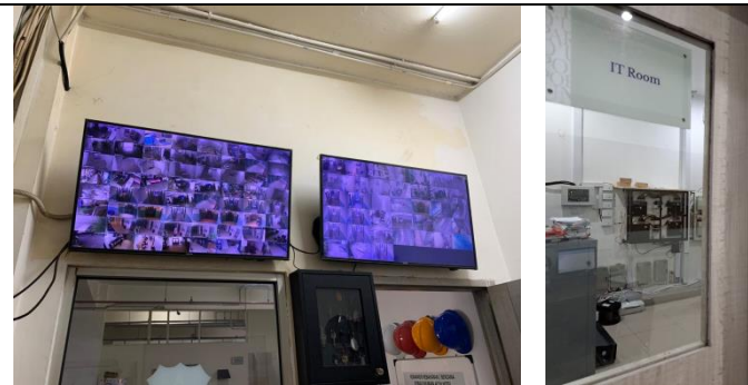
Ruang CCTV dan Server
